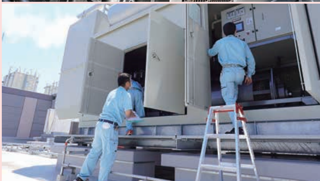
非常用発電機の点検風景。燃料タンクが満タンの状態で、7日間医療活動の維持が可能
